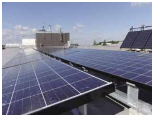
写真1 電気電子システム専門棟屋上の太陽光発電設備
