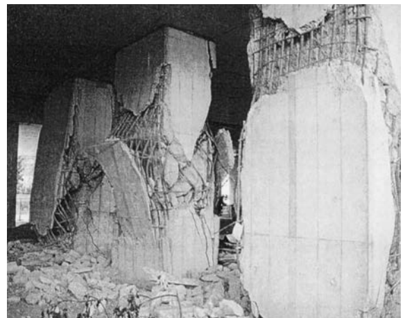
写真-3.6 中国縦貫自動車道宝塚高架橋の橋脚の破損事例
