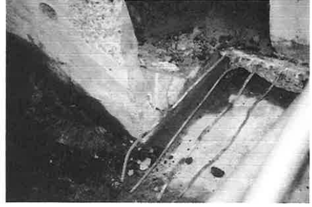
写真-2 プレキャストL型擁壁の破壊状況
