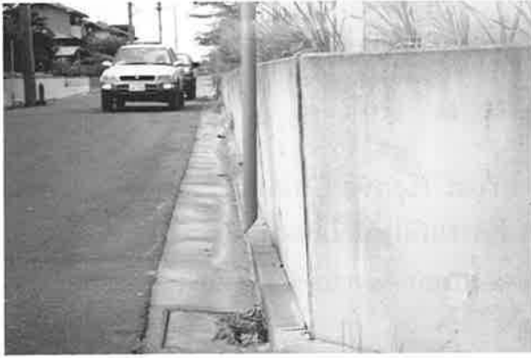
写真-1 プレキャストL型擁壁の変状状況
