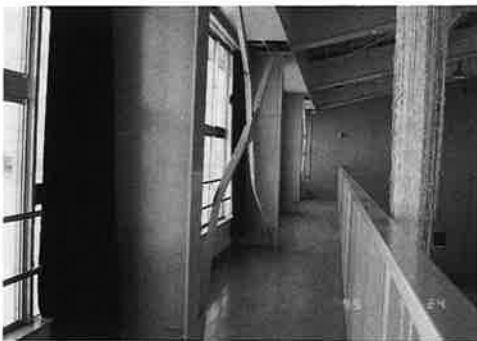
写真-3 ブレースの座屈状況
