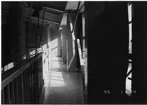
写真-2 ブレースの破断状況
