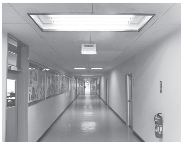
写真1 電気電子システム専門棟2階に導入された直管型LED照明
