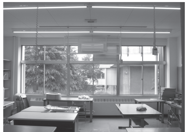
写真2 エジソン倶楽部に導入された直管型LED照明
