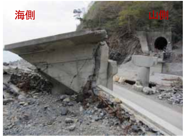
写真 4-3-3-4 橋桁流出 (コイコロベ沢桥梁)
