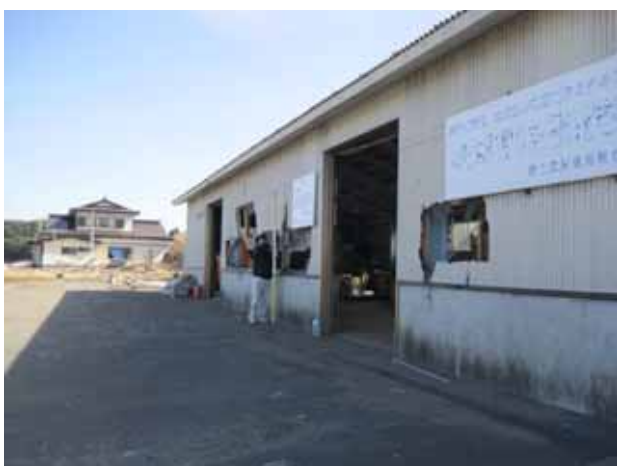
写真 3.3.1.1 階上町大蛇小学校南下十文字商店被害状況 津波 8.44m (TP)
