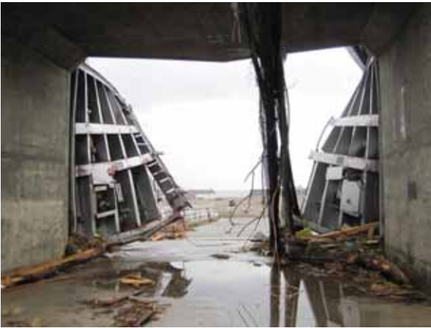
写真3.4.10.14 田老川（田代川）防潮堤門（写真3.4.10.13の門前景）の被災状況（引き波による被災）
