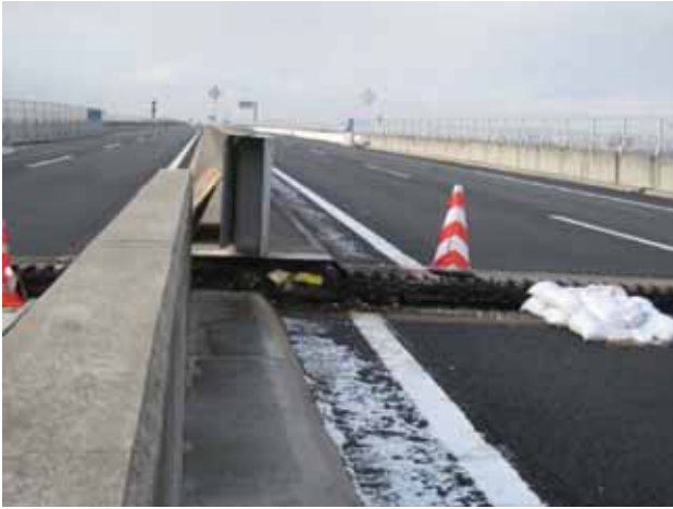
写真4-2-1-3 路面の段差 (仙台東部道路：NEXCO東日本 提供)
