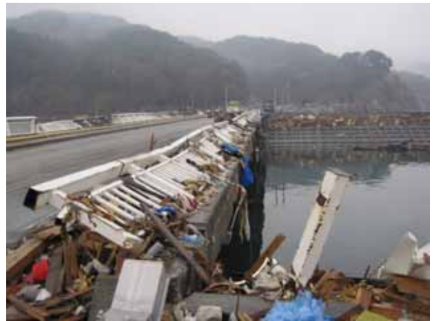
写真3.4.7.6 小槌川右岸、欄干の被災状況
