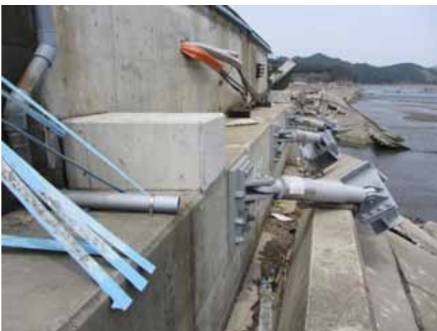
写真 4-2-2-3 落橋装置の破断 (気仙大橋 : 陸前高田市)
