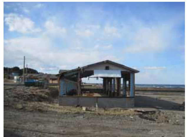
写真 3.3.1.9 階上町大蛇漁港上海産物簡易加工処理センター横の建物被災状況。写真右奥漁港防波堤天端高 TP5.00m。ここを襲った津波=10.73m (TP)。
