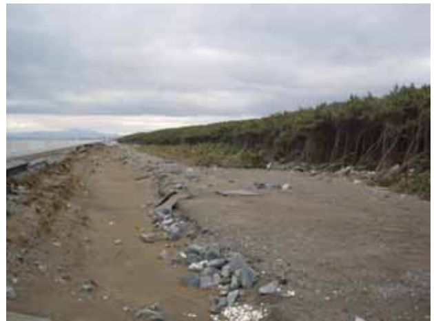
写真3.3.3.10 おいらせ町松原（北）における堤防裏側の法面とりの先の被災状況。越流水深0.80m、堤防天端高7.5mより、津波波高を8.30m (TP) とした。
