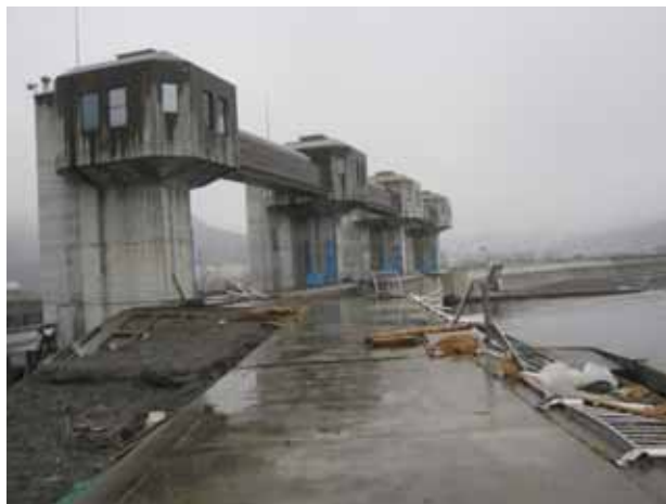
写真 3.4.6.1 大槌川防潮堤水門の被災状況
