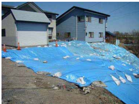
図4-2-20 崩壊した護岸・盛土の様子（田子町）
