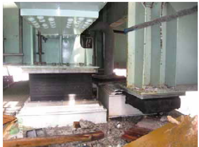
写真4-2-1-2 積層ゴム支承の破断 (東北自動車道 : NEXCO東日本 提供)
