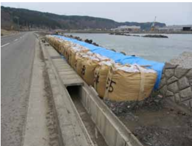
写真 4-2-2-19 護岸の被害（久慈市）
