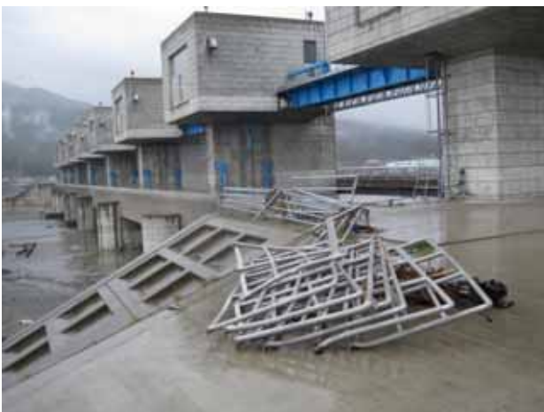
写真 3.4.9.3 津軽石川防潮堤水門 津波は防潮堤を約 8mの越流水深で超えており、両岸家屋の被害は大きい。
