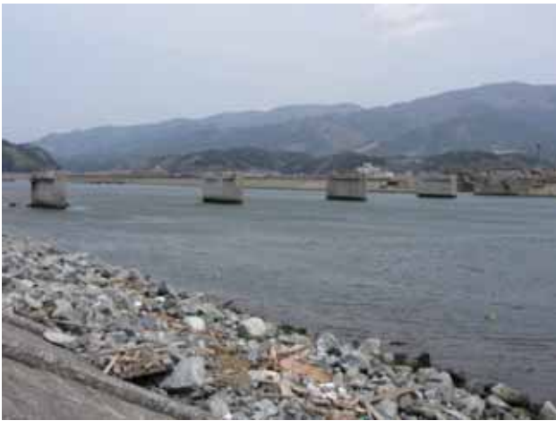
写真 4-2-2-1 橋桁の流出 (気仙大橋 : 陸前高田市)
