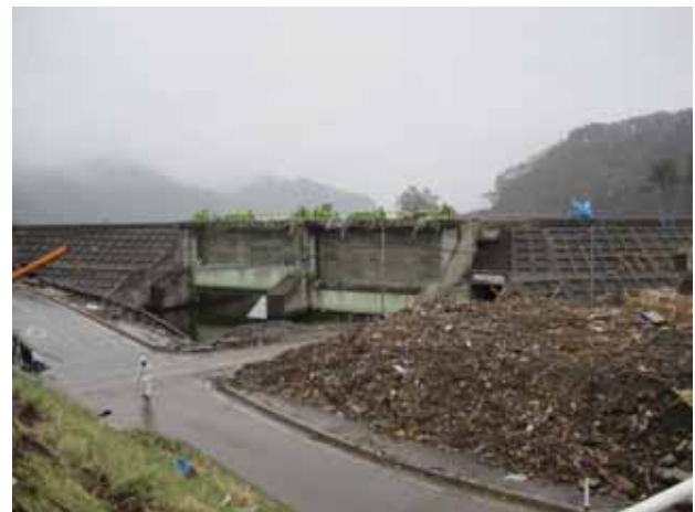
写真 3.4.2.2 熊野川右岸防潮堤背後の家屋被災状況
