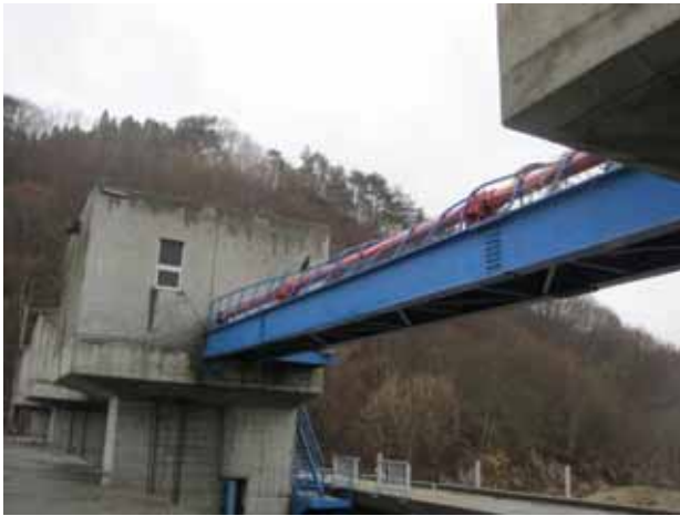
写真3.4.10.8 田老川（田代川）水門上部の被災状況
