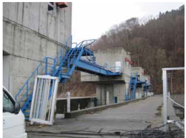
写真3. 4. 10. 6 田老川（田代川）防潮堤水門の被災状況。越流水深約7m。
