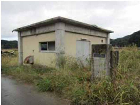
写真6-1-10 陸前高田市 竹駒第2水源地
