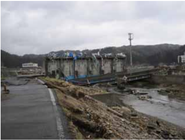
写真 3.4.11.2 長内川右岸および防潮堤水門の被災状況
