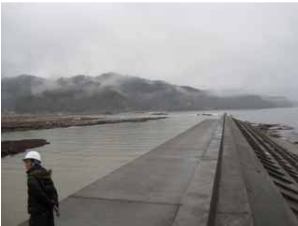
写真3.4.5.9 鵜住居川右岸導流堤、表法（写真堤防左側）が越流した津波により崩壊している
