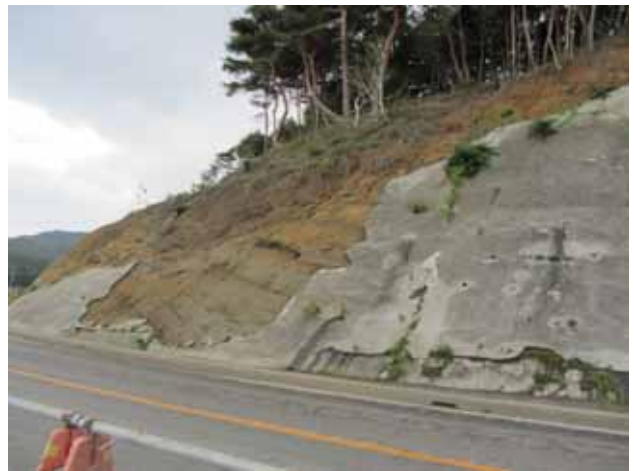
写真 4-2-2-11 吹付けモルタルの損傷 (野田村)
