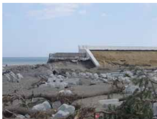
図4-2-15 崩壊した防潮堤（野田村十府ヶ浦）
