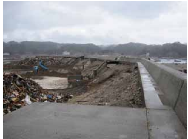
写真3.4.10.11 田老川（田代川）左岸防潮堤裏法面の被災状況
