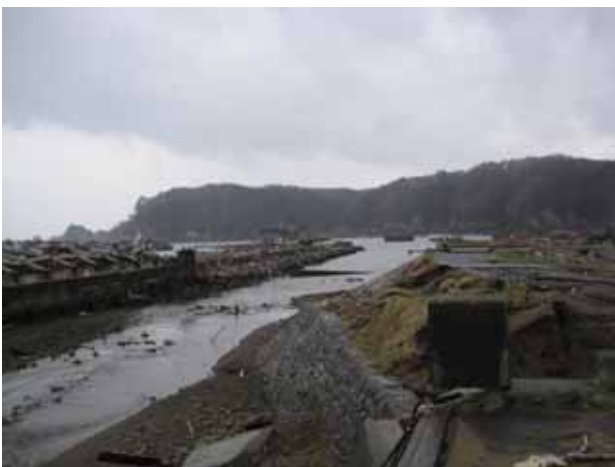
写真3.4.11.10 長内川右岸河口近くの被災状況
