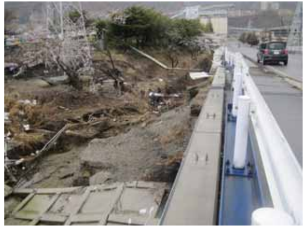
写真3.4.1.22 盛川河口の橋と左岸堤防付け根部分の被災状況
