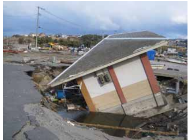
写真 3.3.2.4 蕪島のトイレ被災状況。建物の流出はなかったが地面が津波によりえぐられている。
