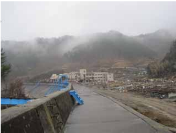
写真 3. 4. 2. 16 熊野川右岸防潮堤背後の被災状況
