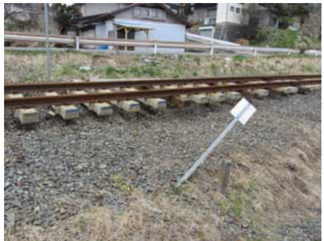
写真 4-3-2-5 道床碎石流出
