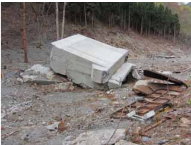
写真 4-3-3-3 流出した橋台 (ハイペ沢桥梁)
