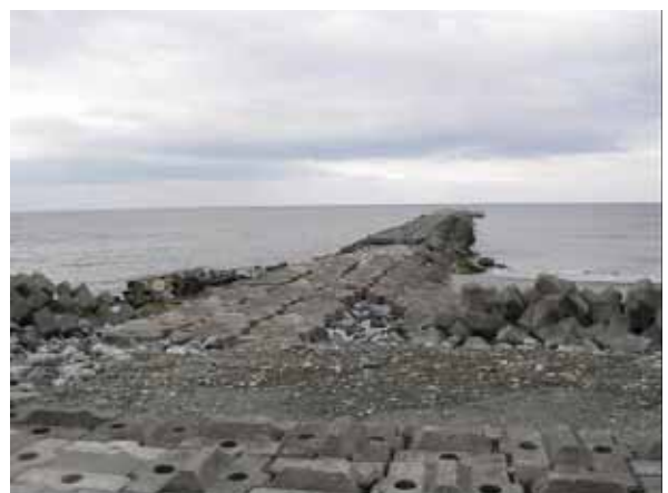
写真 3.3.3.9 奥入瀬町松原、ヘッドランド工の被災状況。津波は写真右から左に向かっている。裏法面の被覆ブロックがはがされている。津波波高 8.71m (TP)
