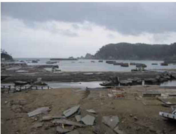
写真 3.4.11.4 長内川河口左岸および大破し、散乱した漁港防波堤コンクリート塊 (写真上部海面上)
