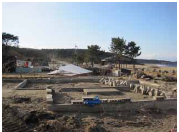
写真 3.3.2.6 八戸市白浜地区の被災状況。家屋は流失し、軒下のコンクリートだけが残る。津波 9.98m (TP)。
