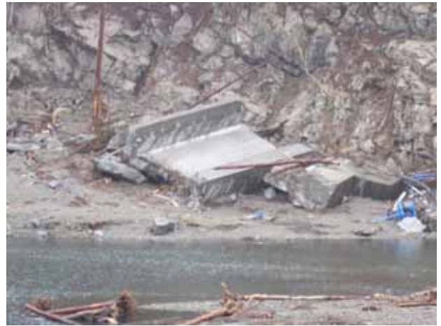
写真3.4.12.11 摂待川左岸の大破した防潮堤水門 のコンクリート塊
