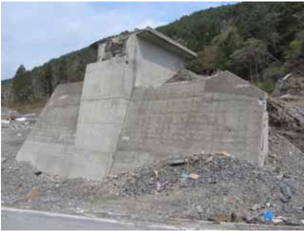
写真4-3-3-7 橋台の損傷（島越駅付近）
