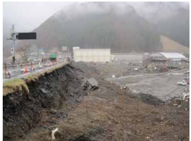
写真 3.4.4.1 水海川左岸国道裏の裏法面被災被災状況
