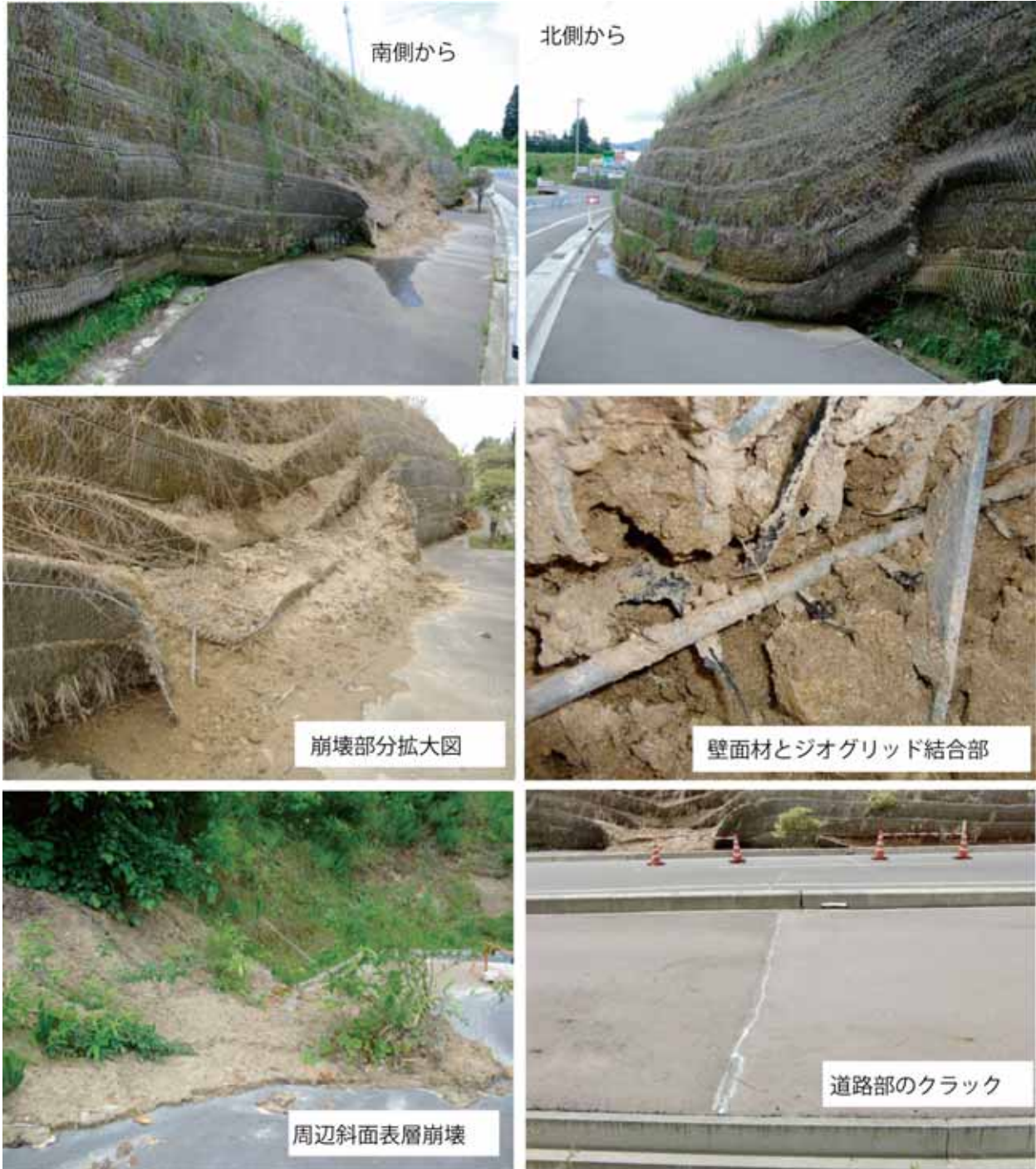
図 4-3-2 崩壊した補強土 (岩手県奥州市水沢区)
