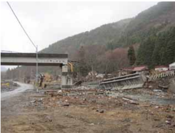
写真 3.4.3.3 片岸川鉄道橋は落ちており、被害は大きい。
