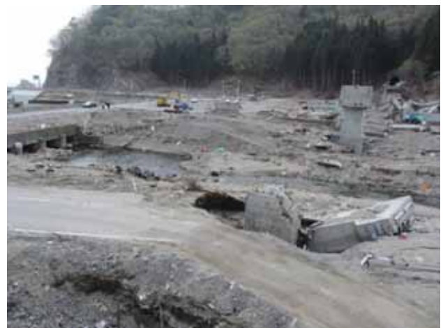
写真 4-3-3-6 潰滅状態の島越駅付近
