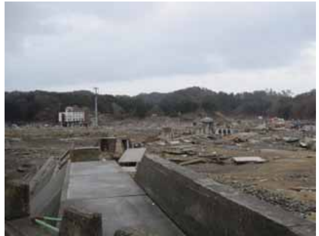
写真3.4.11.6 長内川左岸地区防潮堤の被災状況。右側は海、左側は長内川流域
