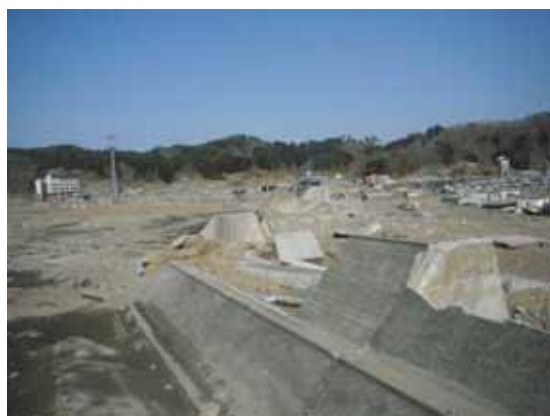
図4-2-13 崩壊した防潮堤（田老地区）
