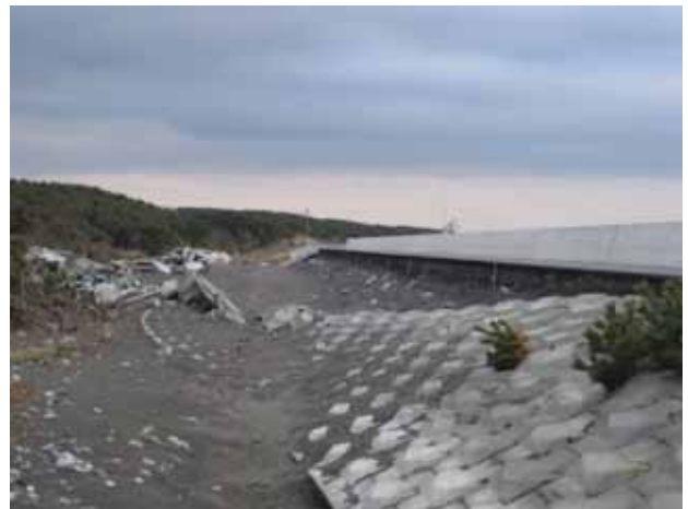
写真3.3.3.11 奥入瀬町深沢における裏法面の被災状況。越流水深1.84m、堤防天端高7.0mより、津波波高を8.84m (TP) とする。
