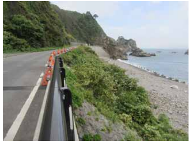
写真 4-2-2-21 防護柵の被害（久慈市）
