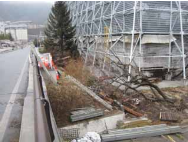
写真3.4.1.20 盛川左岸堤防裏の被災状況
