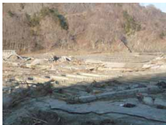
図4-2-14 崩壊した防潮堤（田野畑村明戸地区）
