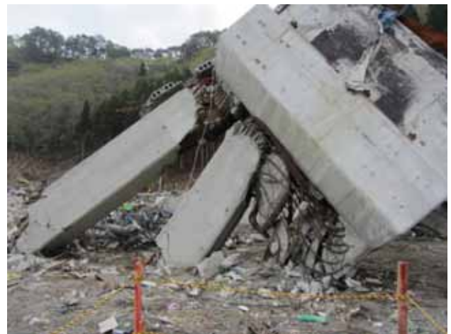
写真4-3-3-10 倒壊した高架橋②（島越駅付近）
