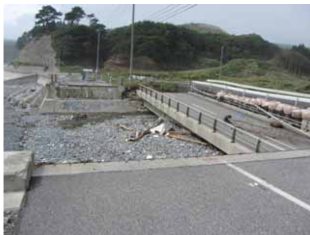
写真 4-2-2-15 桁の落橋 (広内橋: 野田村)
