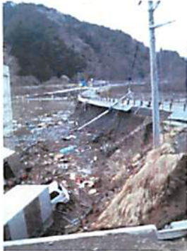
▼写真④(沼田跨線橋:落橋)
