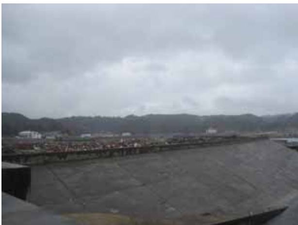
写真3.4.10.10 田老川（田代川）右岸防潮堤。越流水深約10m（推定）。
