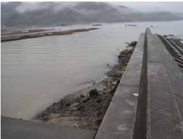
写真 3.4.5.3 鵜住居川河口右岸導流堤法面の被災状況。右岸導流堤帝先端部が大破、流失
