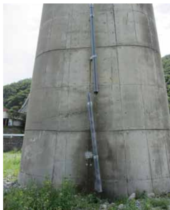
写真 4-3-3-16 排水装置が損傷した橋脚
