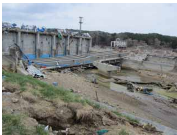
写真 4-2-2-17 桁の落橋 (みなと橋: 宮古市)
