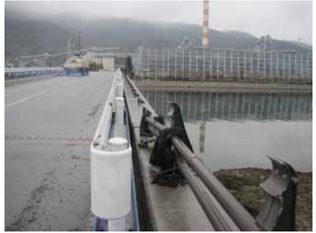
写真 3.4.1.16 盛川河口最下流地点の橋の欄干被災状況 (白色ガード柵は復旧工事で設置)
