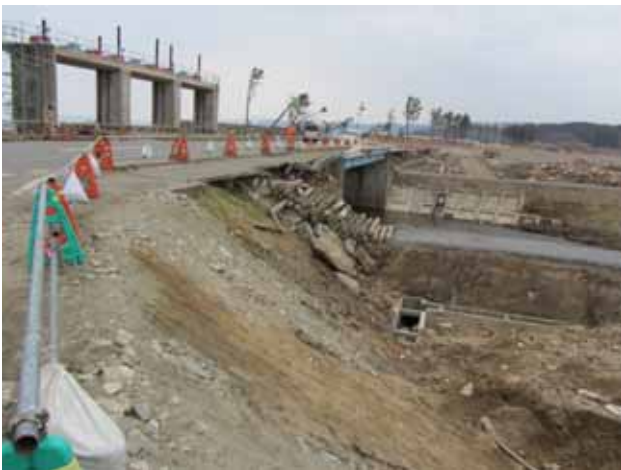
写真 4-2-2-9 盛土の流出 (応急復旧後：平成 23 年 4 月撮影)
