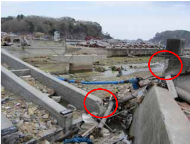
写真 4-2-2-18 桁端・橋台の損傷（みなと橋：宮古市）
