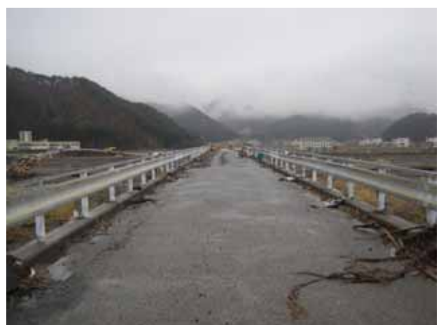
写真3.4.5.7 鵜住居川左岸堤防の被災状況
