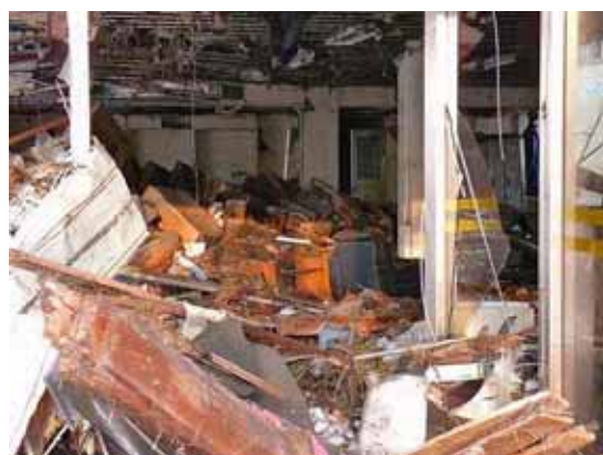
写真 6-3-5 岩手県、大町ビルの被災 NTT 東日本 HP から
