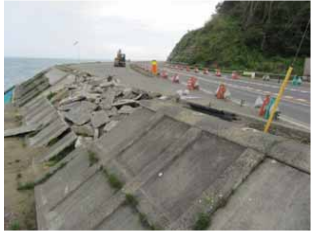
写真 4-2-2-10 海岸護岸の損傷 (野田村)
