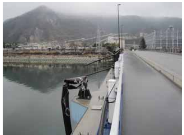
写真 3.4.1.18 盛川河口橋脚欄干被災状況 (欄干が津波により大破)
