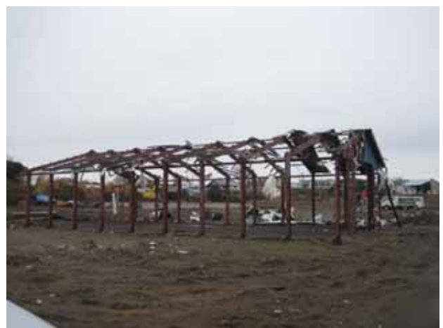
写真3.3.3.12 三沢漁港南三川目地区の被災状況。小水路を遡上して海岸林を抜けてきた津波による建物の被災状況。
