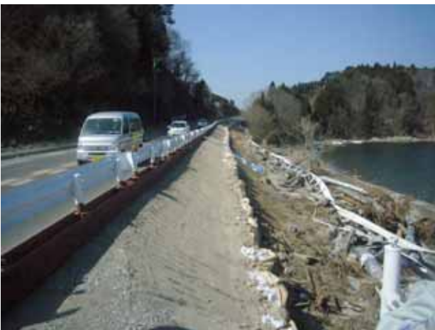
図4-2-26 津波による道路盛土の浸食（岩手県宮古市）
