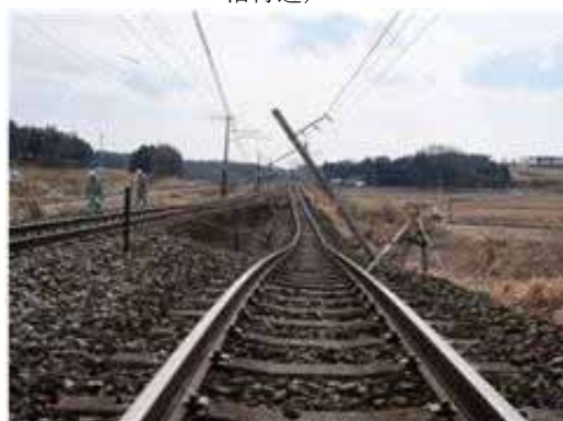
図4-2-23 盛土崩壊による鉄道被害（東北本線梅ヶ沢-新田間） 13)
