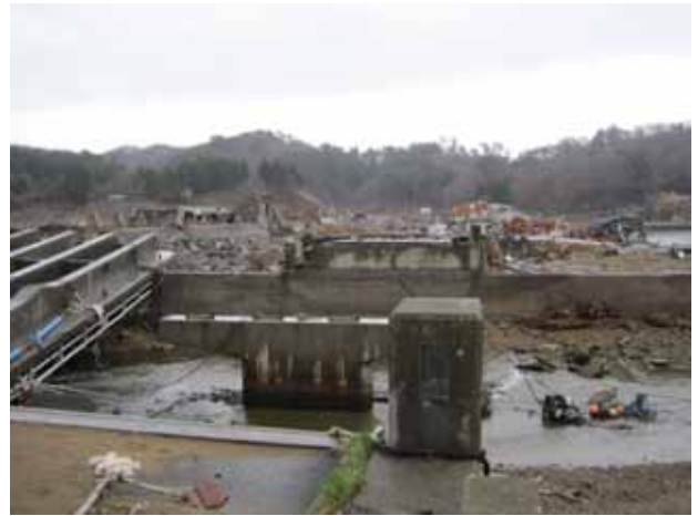
写真3.4.11.11 長内川右岸から左岸にかけて大破した橋をみる
