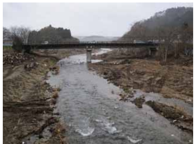
写真 3.4.10.1 田老川（田代川）左岸から国道（45号線）橋。川は津波が遡上し、植物は褐色になっている。
