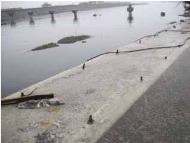
写真 3.4.6.3 大槌川右岸堤防胸壁大破流失後の様子
