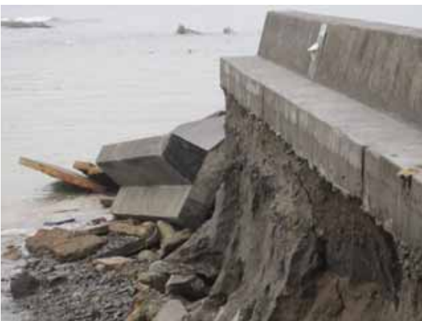
写真 3.4.5.15 鵜住居川河口部右岸導流堤表法面の被災状況
