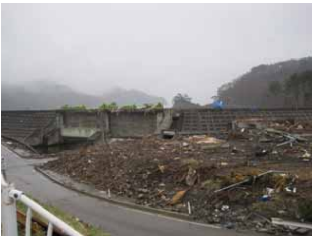
写真 3.4.2.1 熊野川防潮堤周辺の被災状況
