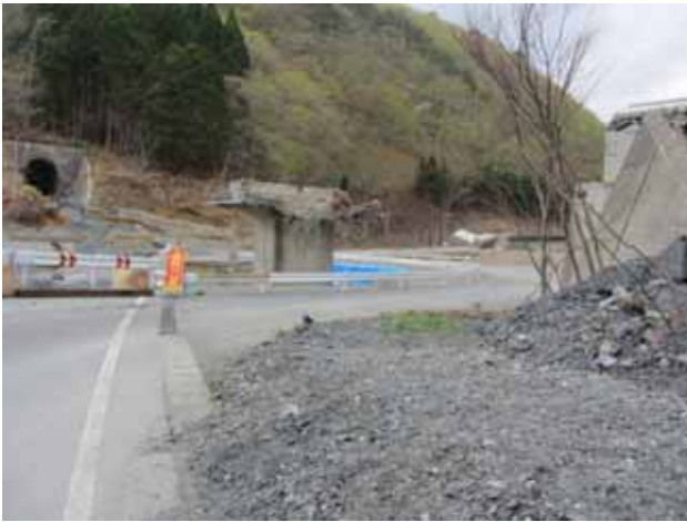
写真 4-3-3-1 橋桁流出 (ハイペ沢桥梁)
