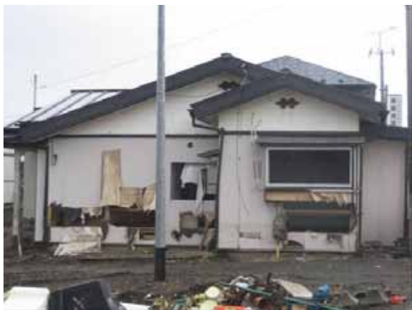
写真 3.3.3.5 明神川右岸の百石漁港を超えて、さらに、その陸側の堤防を越えて民家を襲った津波による被災状況を示す。越流水深 1.57m、堤防天端高 6.0m より、津波を 7.57m (TP) とした。
