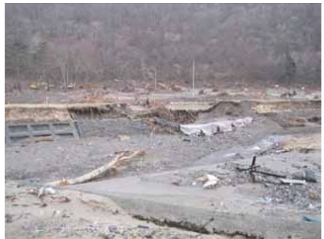
写真3.4.14.1 明戸川左岸被災状況
