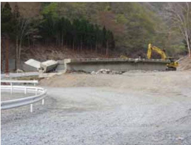
写真 4-3-3-2 流出した桁 (ハイペ沢桥梁)
