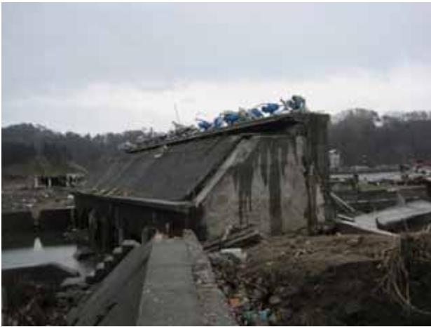
写真3.4.11.14 長内川防潮堤水門の被災状況、両サイドの防潮堤は流失。
