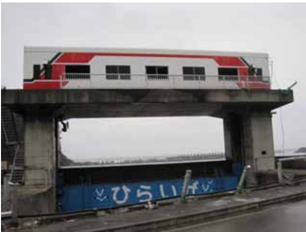
写真 3. 4. 13. 9 平井賀川水門全景被災状況
