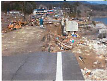
▼写真③(鳥谷坂橋A1:橋台背面盛土崩落)
