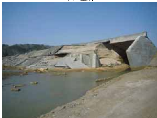
(b) 破堤した部分の脇の内側から洗掘された様子 図4-2-12 宮古湾最奥部津軽石川河口付近の防潮堤
