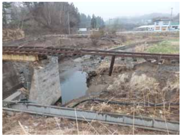
図4-2-28 津波による鉄道橋の橋台周辺の変状（陸前八木駅付近）
