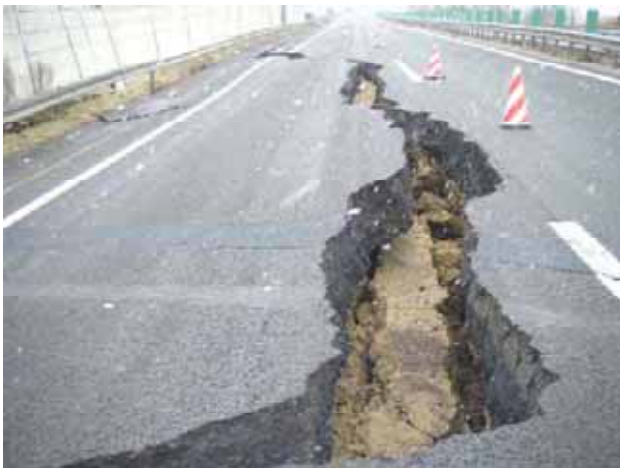
写真4-2-1-1 路面の陥没と亀裂 (仙台東部道路 : NEXCO東日本 提供)
