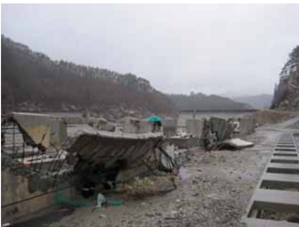
写真 3.4.12.4 摂待川右岸河口にある漁協の養殖場（上物は大破、流失）
