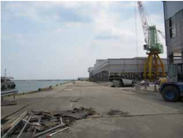
写真 3.4.17.3 久慈川右岸北久慈工業港の被災状況。
