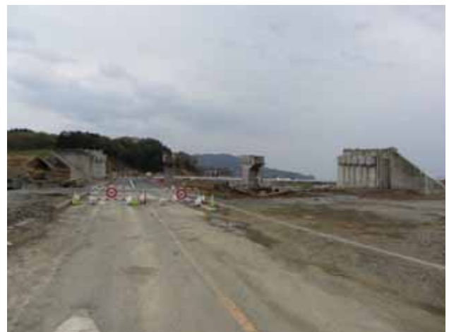
写真 4-2-2-6 上部工・橋台背面盛土の流出 (沼田跨線橋 : 陸前高田市)
