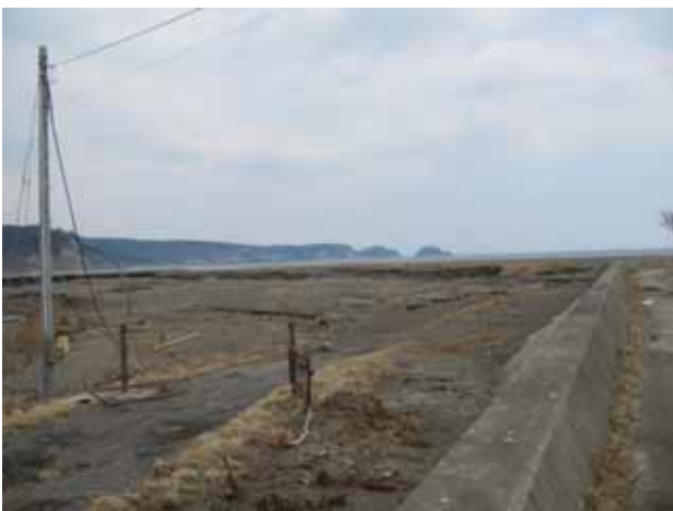
写真 3.4.17.4 久慈川右岸河口部の津波による砂州の浸食。
