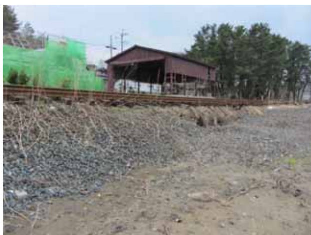
写真 4-3-2-8 軌道変位 (八木川橋梁付近)
