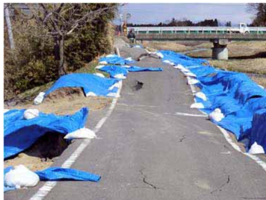
図4-2-4 堤防天端の変状（多田川国道347号線付近） 7)
