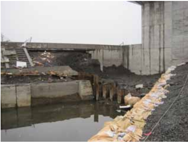
写真 3. 4. 6. 8 大槌川防潮堤裏の被災状況
