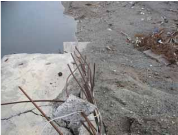
写真3.4.12.14 摂待川右岸水門接合部の破断状況
