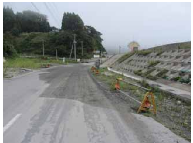
写真 4-2-2-22 舗装の被害（野田村）
