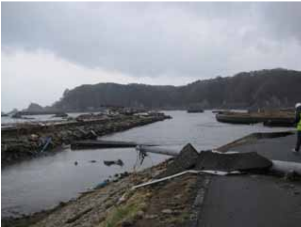
写真3.4.11.9 長内川右岸、河口付近の大破した橋 (町管理)
