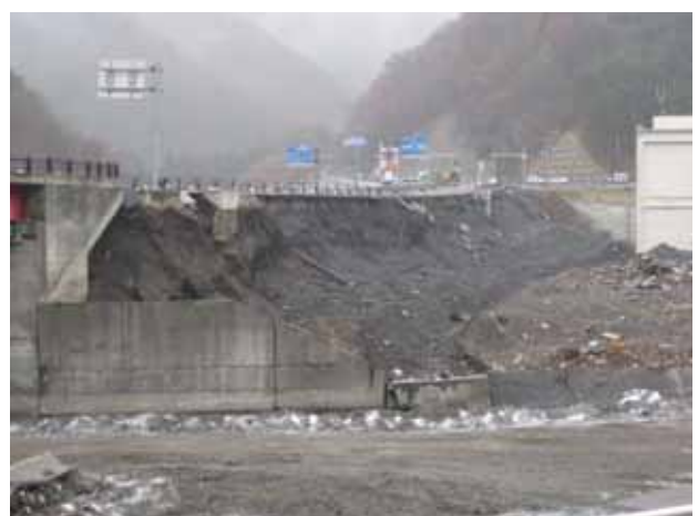
写真 3.4.4.7 水海川右岸国道を越えた津波による法面被災状況
