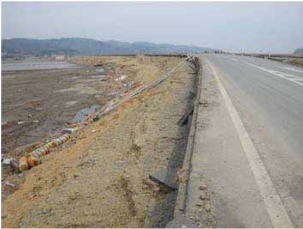
図4-2-7 新北上大橋周辺左岸の河川堤防裏法の浸食 10)
