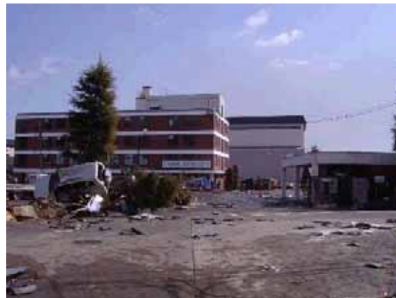
写真 6-3-1 仙台火力発電所の津波による被害状況 (宮城県七ヶ浜町)
