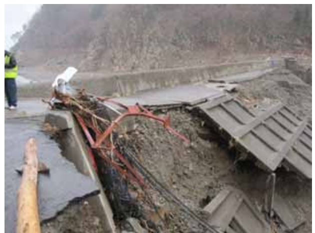
写真3.4.12.13 摂待川右岸防潮堤、裏法面被覆コ ンクリートブロック崩壊状況
