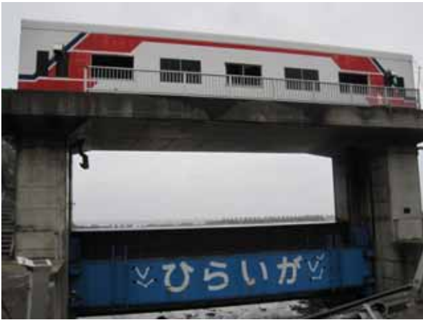
写真 3. 4. 13. 8 平井賀川中央水門の被災状況
