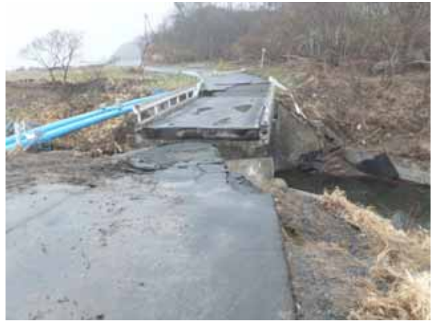
図4-2-27 津波による道路橋の橋台周辺の変状（陸前八木）
