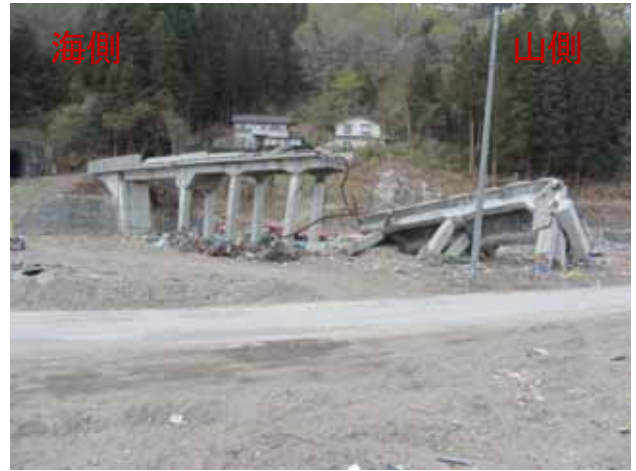
写真4-3-3-9 倒壊した高架橋①（島越駅付近）
