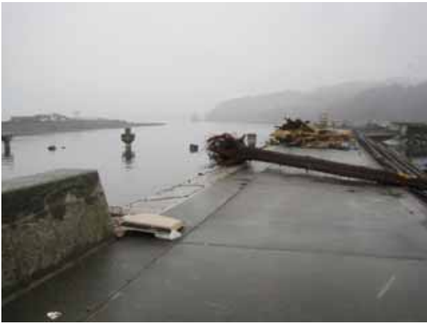
写真 3.4.6.2 大槌川右岸堤防と大破した鉄道橋の残った橋脚
