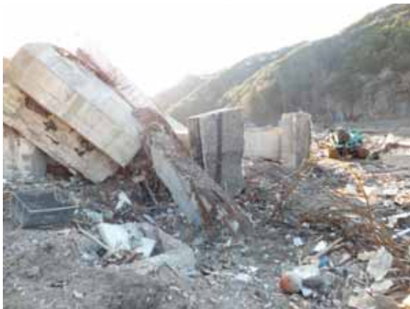
図4-4-2 津波により破壊した橋脚の基礎（田野畑村島越地区）
