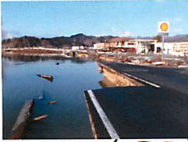
▼写真②(浪板橋:橋台背面盛土流出)
