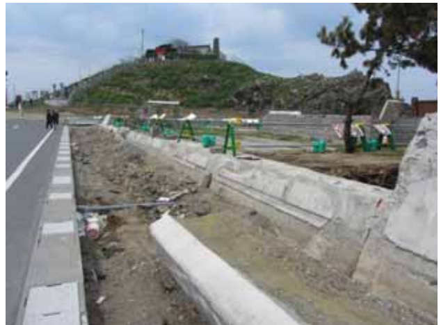
写真 4-2-2-12 歩道舗装の洗掘 (八戸市蕪島)
