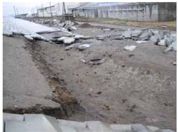
写真 3.3.3.8 奥入瀬町松原地区の堤防被災状況。越流した津波による裏法面の破壊が見られ、法面被覆ブロックの被災と裏法面洗掘が進行している。越流水深 1.21、天端高 7.5m より、津波波高 8.71m (TP) m とした。
