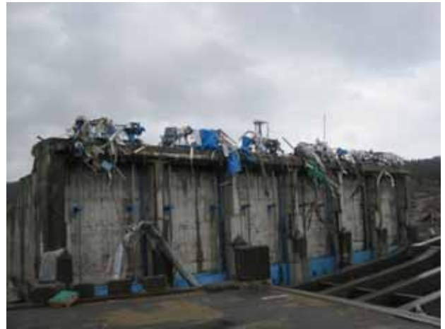
写真3.4.11.12 長内川防潮堤水門の被災状況。水門の上部建造物は大破し、消失。
