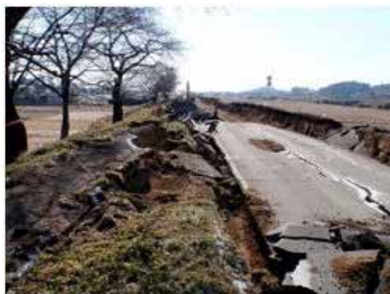
図4-2-21 盛土の側方流動による道路被害（栗原市本吉街道） 13)
