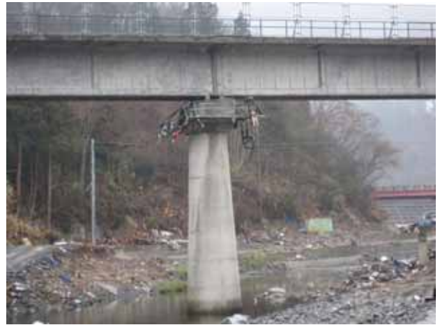
写真 3.4.2.12 熊野川国道 45 号橋脚にかかったゴミ
