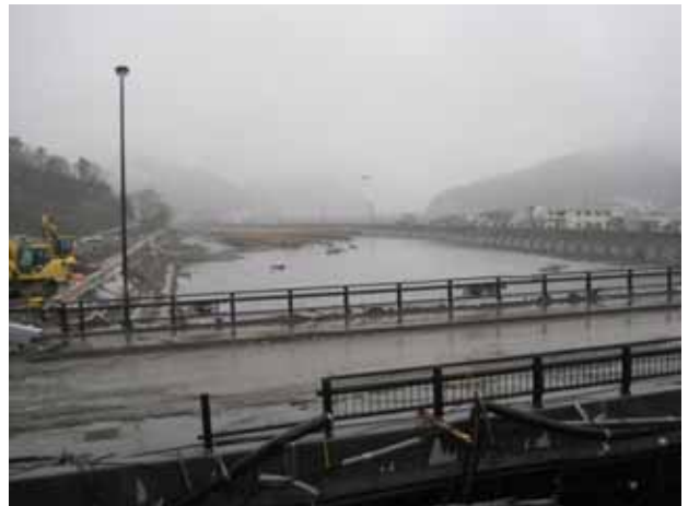
写真 3.4.6.6 大槌川橋欄干の被災状況
