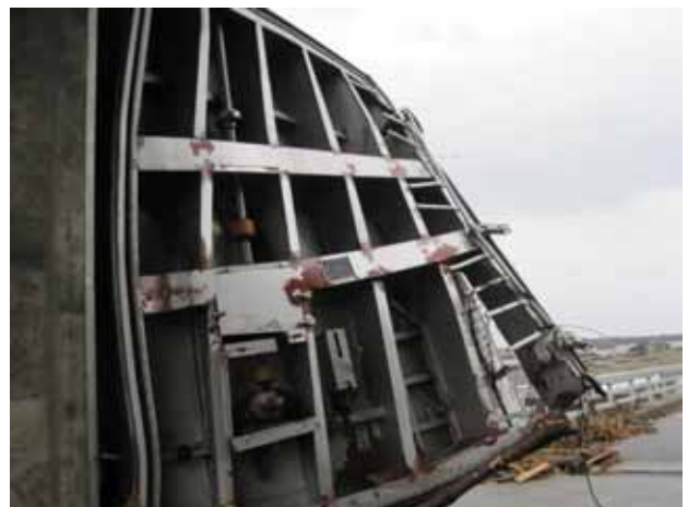
写真3.4.10.13 田老川（田代川）防潮堤門の被災（引き波による被災）
