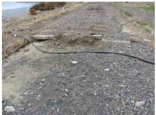
写真 4-3-2-6 線路流出 (大浜川橋梁付近)
