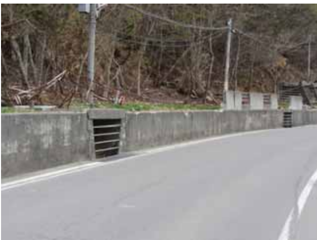
写真 4-2-2-20 防護壁の被害（久慈市）
