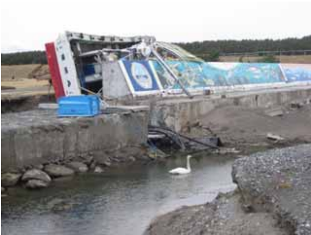
写真 3.3.3.14 三沢漁港南防波堤の被災状況、防波堤胸壁は流失、裏側基礎工が洗掘されている。洗掘は深く白鳥の憩いの場となっている。津波 6.95m (TP)。
