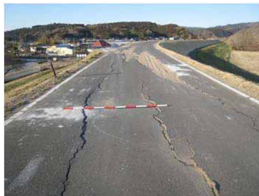
図4-2-5 堤防天端の縦断亀裂（北上川右岸45.5km付近） 8)
