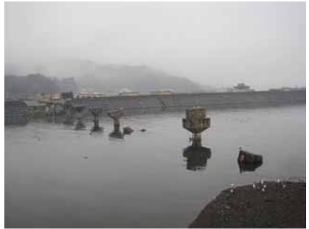
写真3.4.7.5 小槌川右岸大破した鉄道橋の被災状況
