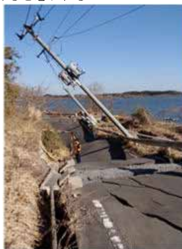
図4-2-22 片切り斜面の崩壊による道路被害（登米市長沼付近） 13)
