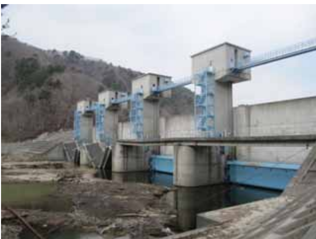
写真 3.4.15.4 普代川防潮堤水門の上流側の様子。 越流した津波により歩道橋が破壊。防潮堤天端高 15.5m
