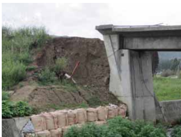
写真4-3-3-12 橋台背面盛土の流出（野田村）
