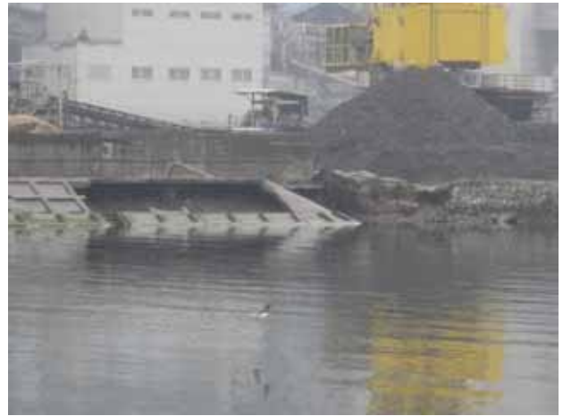
写真3.4.1.10 盛川河口左岸の被災状況
