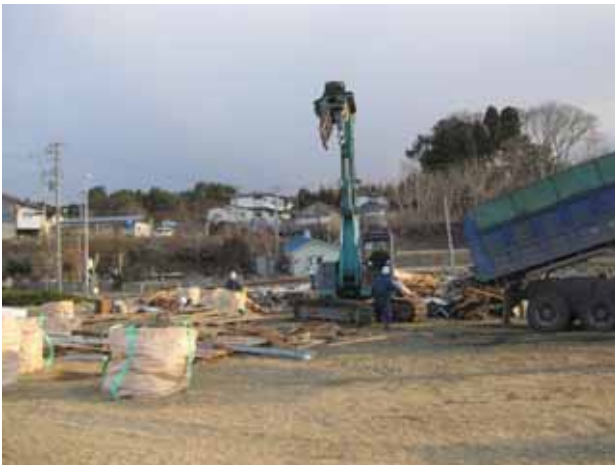
写真 3.3.2.8 八戸市白浜地区の被災状況。流失家屋は瓦礫となり、重機によりその撤去作業を行っている。
