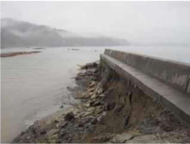
写真 3.4.5.14 鵜住居川河口右岸導流堤表法の被災状況
