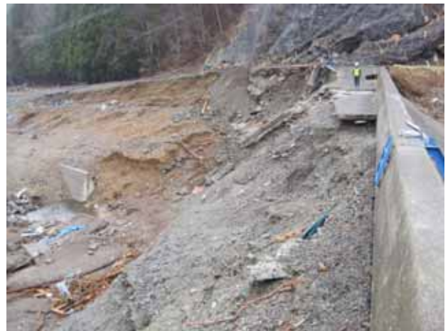
写真 3.4.12.1 摂待川防潮堤右岸裏法面の被災状況
