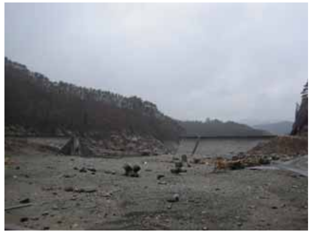
写真3.4.12.5 摂待川右岸より大破した防潮堤をみる。
