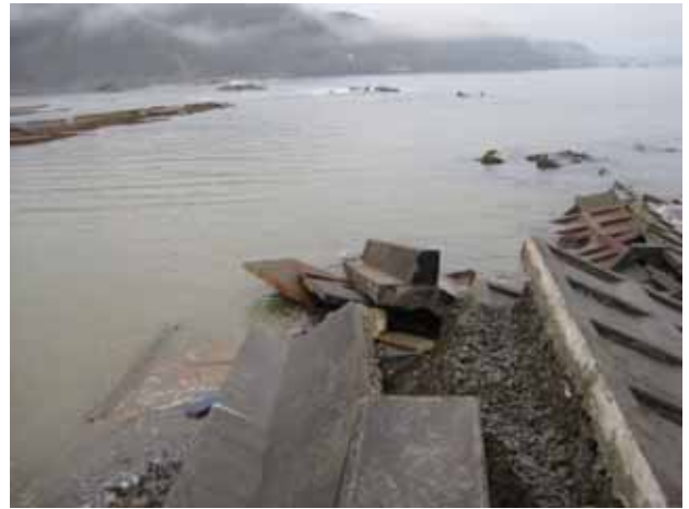
写真 3.4.5.11 鵜住居川河口部右岸導流堤被災状況
