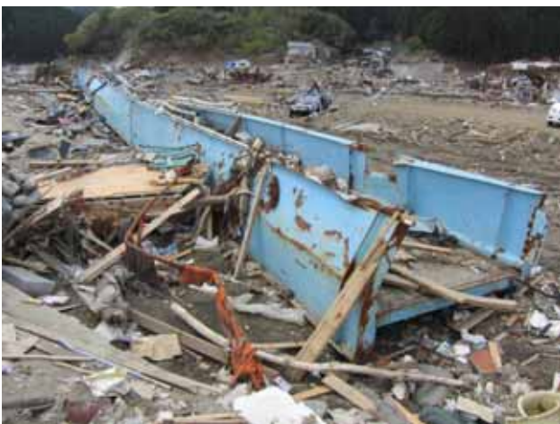
写真 4-2-2-2 流出した上部工 (気仙大橋 : 陸前高田市)
