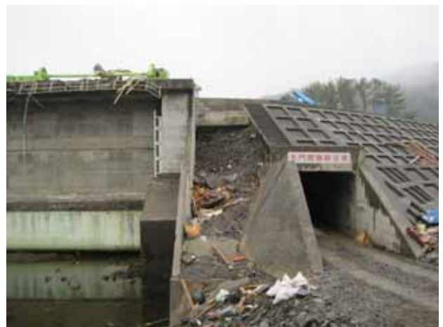
写真 3.4.2.13 熊野川防潮堤裏法面被災状況
