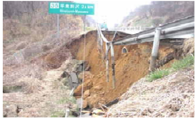
写真4-2-1-6 4/4余震による盛土の崩落 (東北自動車道：NEXCO東日本 提供)
