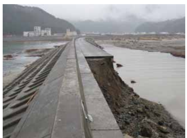
写真 3.4.5.13 鵜住居川右岸導流堤表法の被災状況
