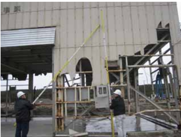
写真 3.3.3.15 三沢漁港南漁具保全施設の被災状況。津波は 6.95m (TP)。
