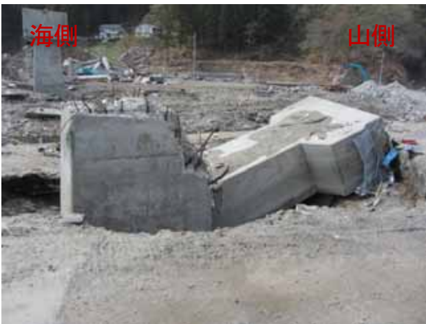
写真4-3-3-8 倒壊した橋脚（島越駅付近）
