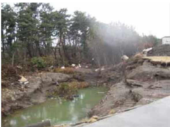
写真 3.3.3.6 奥入瀬川左岸明神川右岸の被災状況。越流した津波による堤防裏法面先の洗掘が進んでいる。越流水深 1.57m、堤防天端高 6.0m より、津波を 7.57 (T) とした。
