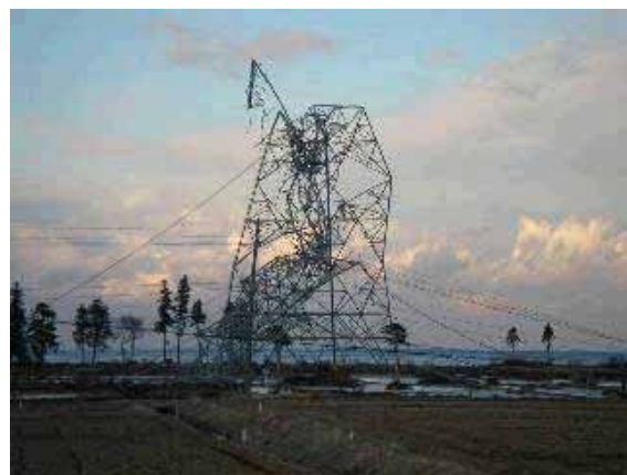
写真 6-3-2 送電鉄塔の折損状況 (福島県南相馬市)
