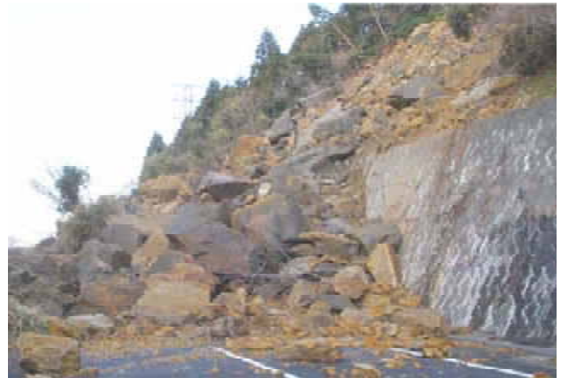
写真4-2-1-7 4/11余震による切土のり面の崩落 (常磐自動車道：NEXCO東日本 提供)
