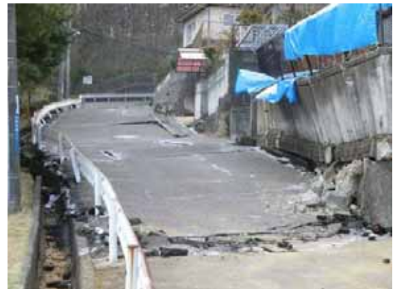
図4-2-18 宅地造成盛土の被害（仙台市折立）
