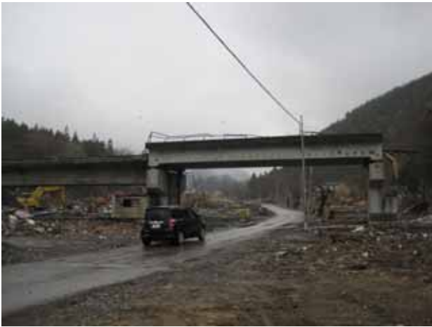
写真3.4.3.8 片岸川鉄道橋の被災状況（落橋）
