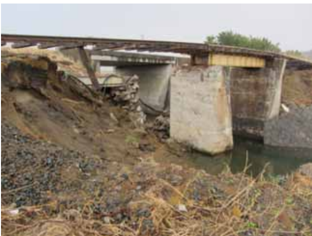
写真 4-3-2-3 盛土流出 (八木川橋梁)
