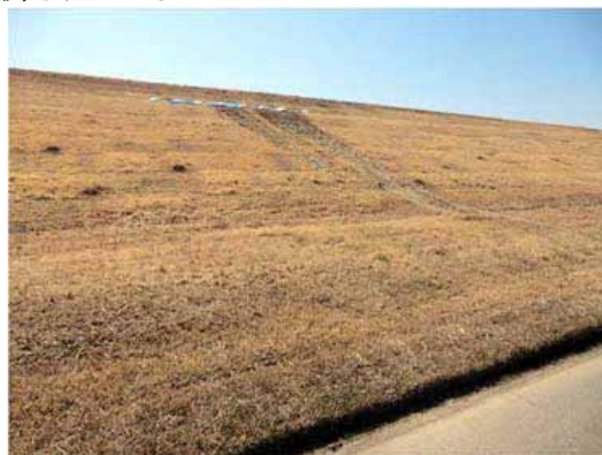
図4-2-3 法面を流れる噴砂（吉田川左岸16.5km付近） 7)
