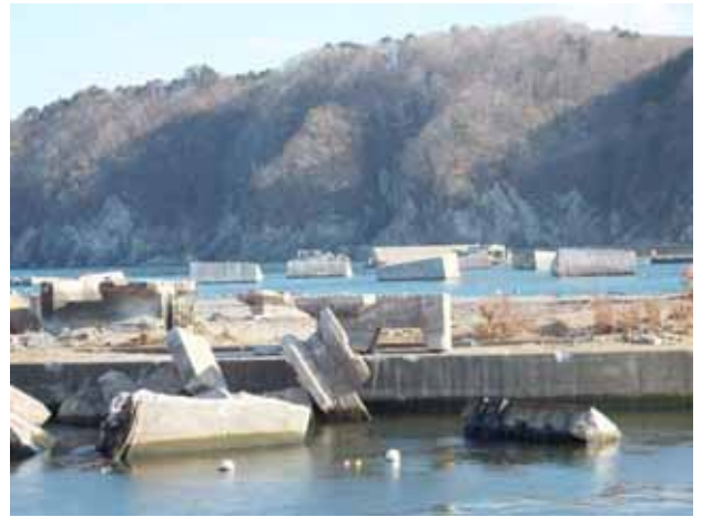
図4-4-6 転倒したゲートソン（宮古市田老地区）
