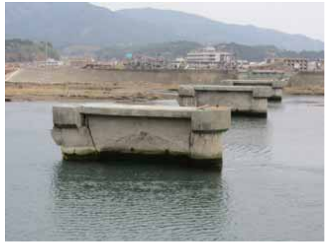
写真 4-2-2-4 橋桁の流出 (姉歯橋 : 陸前高田市)
