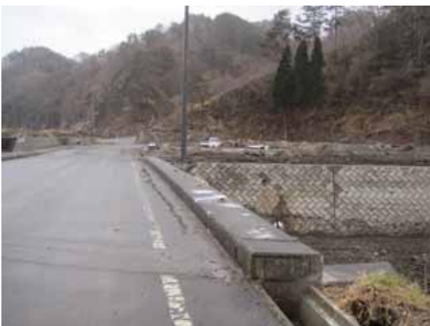
写真 3. 4. 13. 10 平井賀川防潮水門直上の橋欄干の流失状況
