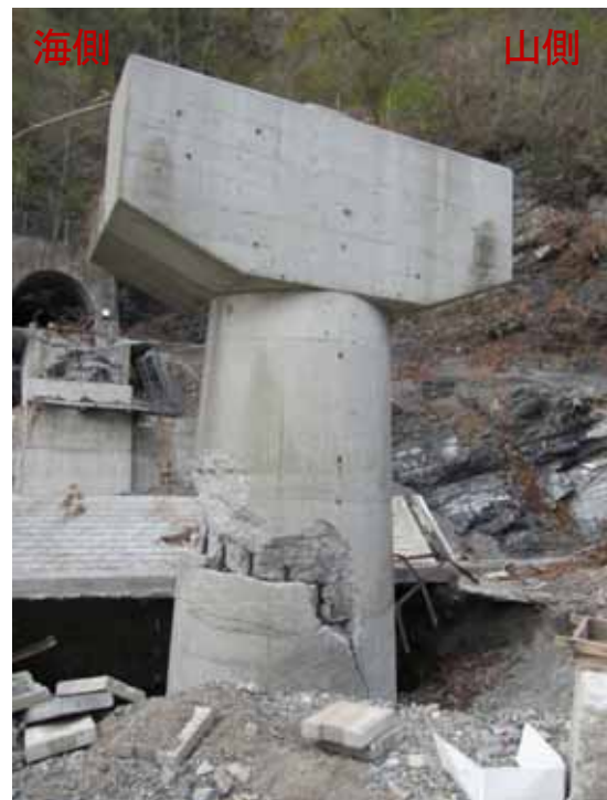
写真 4-3-3-5 損傷した橋脚 (コイコロベ沢桥梁)
