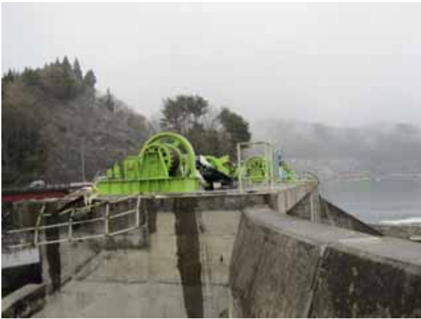
写真 3. 4. 2. 15 熊野川防潮堤水門被災状況
