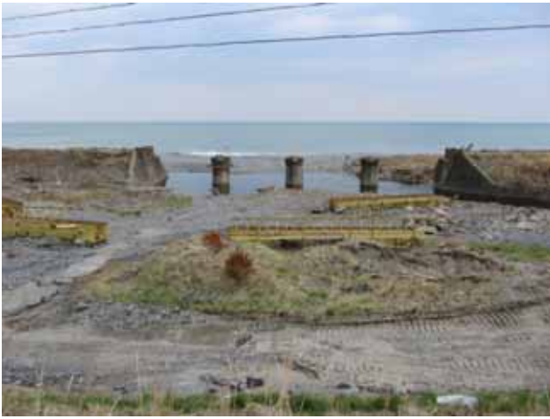
写真 4-3-2-1 橋桁流出 (大浜川橋梁)
