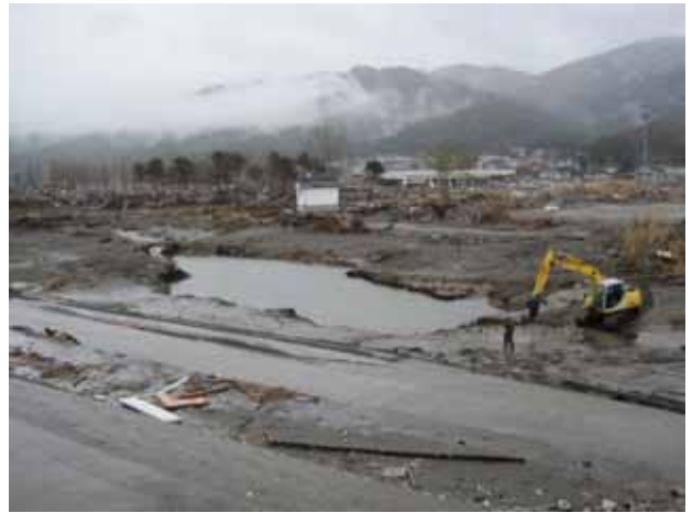
写真 3.4.9.11 津軽石川河口右岸街区の壊滅状況
