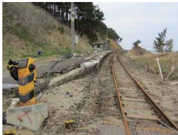
写真 4-3-2-9 駅舎・踏切の被害 (有家駅)
