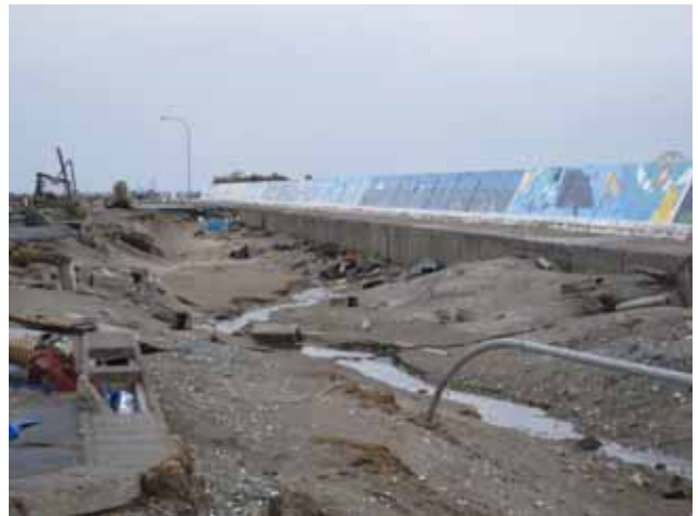
写真 3.3.3.16 三沢漁港南防波堤被災状況、越流した津波は堤防裏側を洗掘、アスファルト舗装を剥ぎ、路盤を洗掘、防波堤胸壁一部を破壊。津波は 6.95m (TP)。
