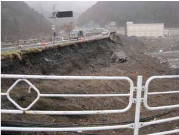
写真 3.4.4.8 水海川左岸 国道を越えた津波による法面被災状況
