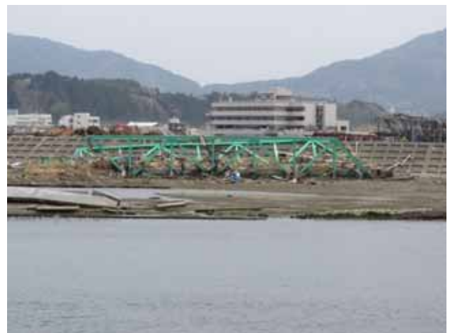
写真 4-2-2-5 流出した上部工 (姉歯橋 : 陸前高田市)
