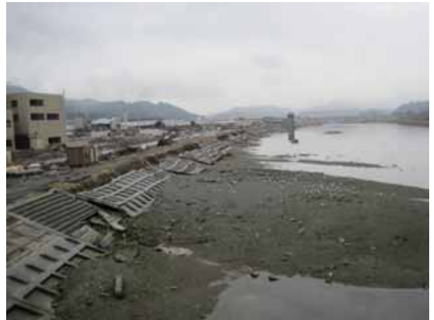
写真 3.4.1.17 盛川右岸堤防被災状況
