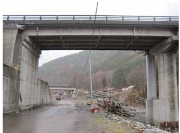
写真3.4.3.6 片岸川国道（45号線）橋付近の被災状況。橋には被害なし。
