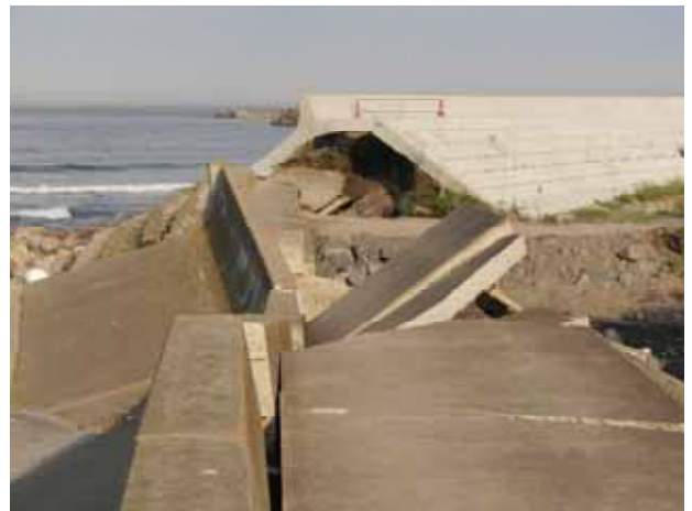
図4-2-10 破堤した河川堤防（五戸川河口右岸）
