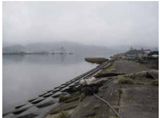
写真3.4.1.5 盛川右岸 被災状況
