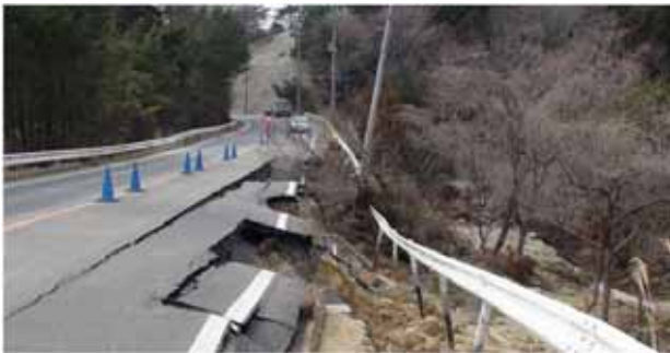
図4-2-25 津波による道路盛土の変状（牡鹿半島） 14)
