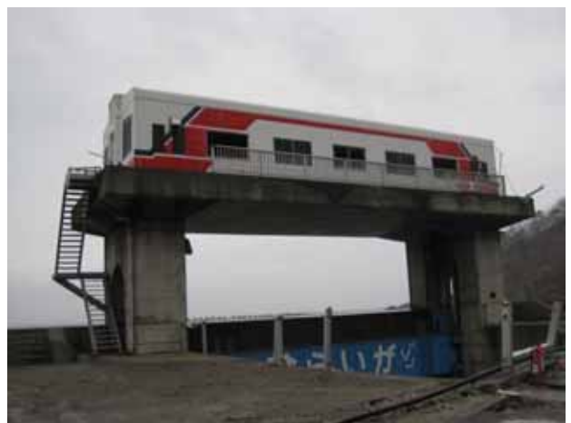
写真 3.4.13.7 平井賀川河口左岸水門の被災状況
