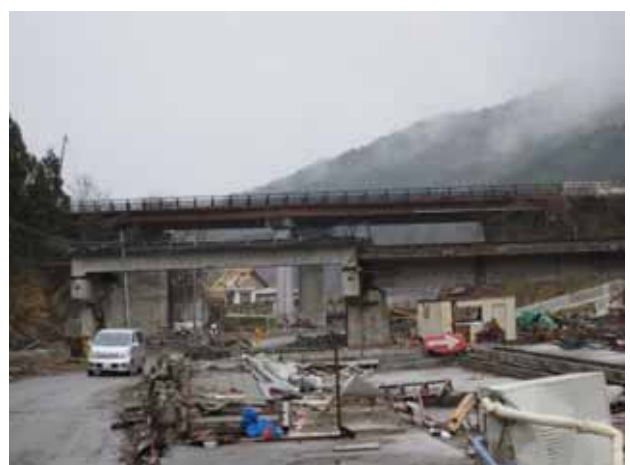
写真3.4.3.7 片岸川鉄道橋の被災状況、レールが流失している。
