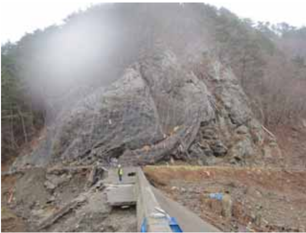
写真 3.4.12.2 摂待川防潮堤右岸裏法面の被災状況。表法面被災軽微。
