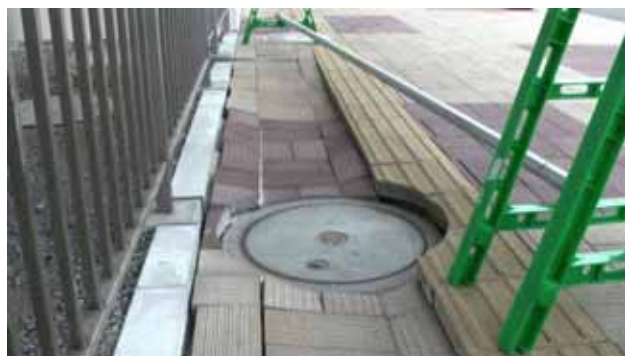
図4-1-1 埋設管回りの沈下（三沢駅東口）
