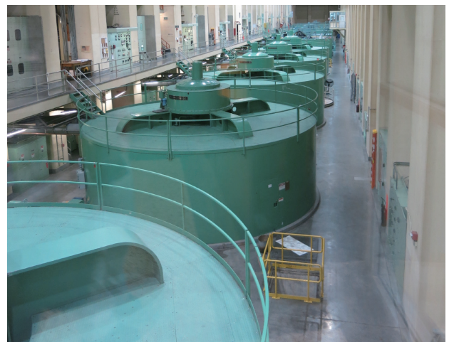
図7 グランドクーリーダムの発電機
