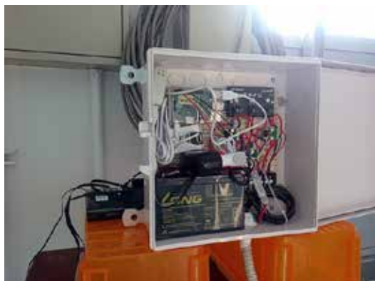
図 11 電気棟 4 階でのシステムの稼働の様子
